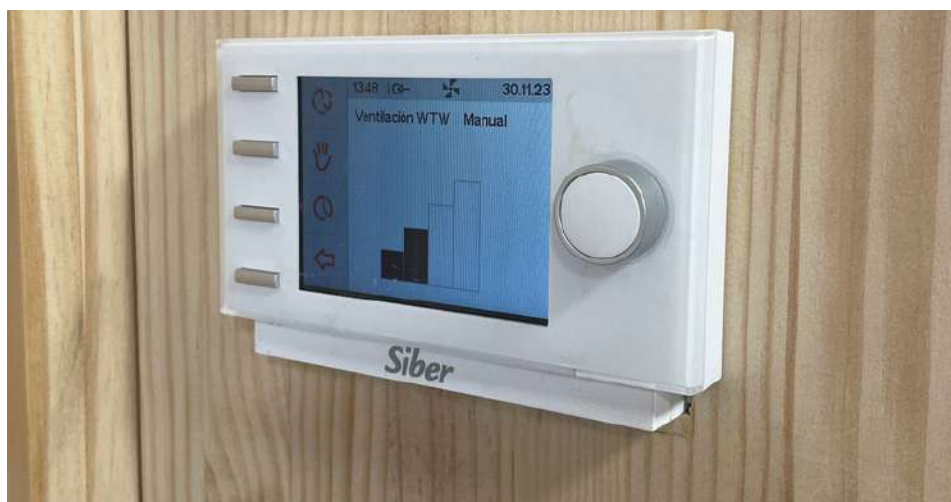
Sistema de control climatización Minimal y Sellos Passivhaus + Well.
