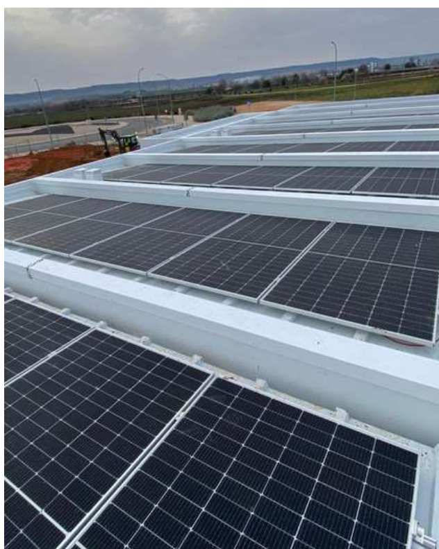
Placas solares, Cubiertas Minimal Montepino en Illescas.
